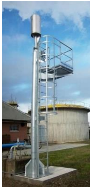
Figura 32. Quemador de los gases sobrantes. Fuente: Varec biogás
